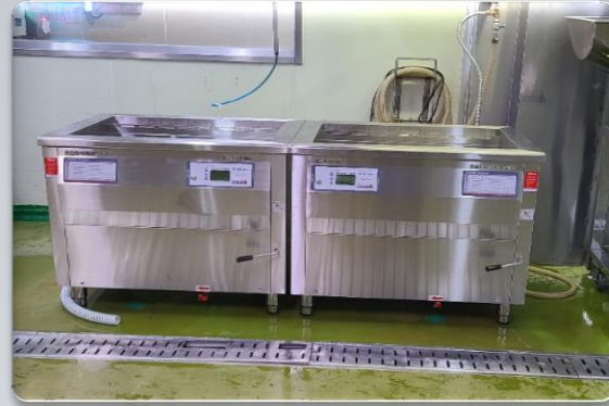
C 공장 1공장 KSVR-1000 2대
