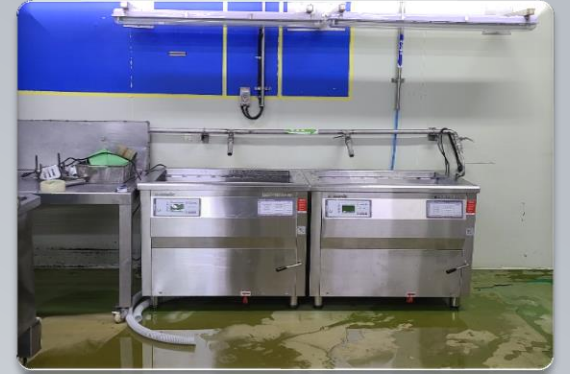
C 공장 2공장 KSVR-1000 2대
